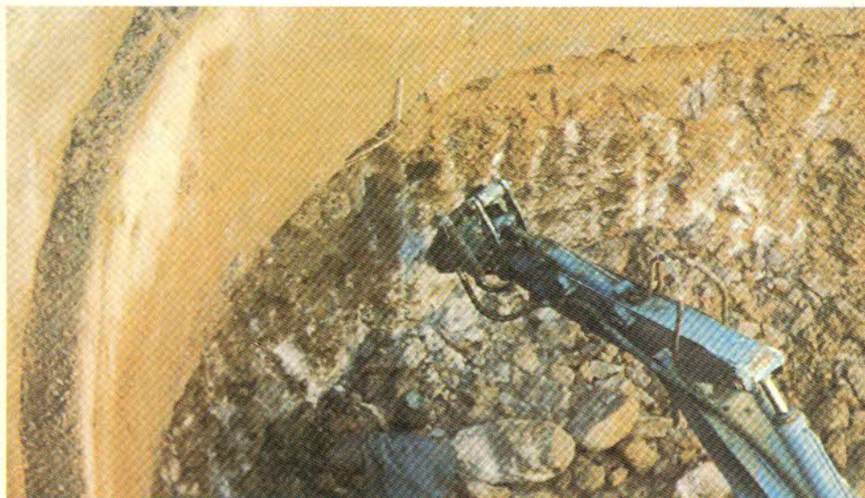
Fig. 11 - Scavo con «martellone» Atlas attraverso i grossi blocchi del pozzo n. 21 a 6 m di profondità □ The powerful Atlas hammer at work among the big boulders and pebbles of well no. 21, at a depth of 6 m
