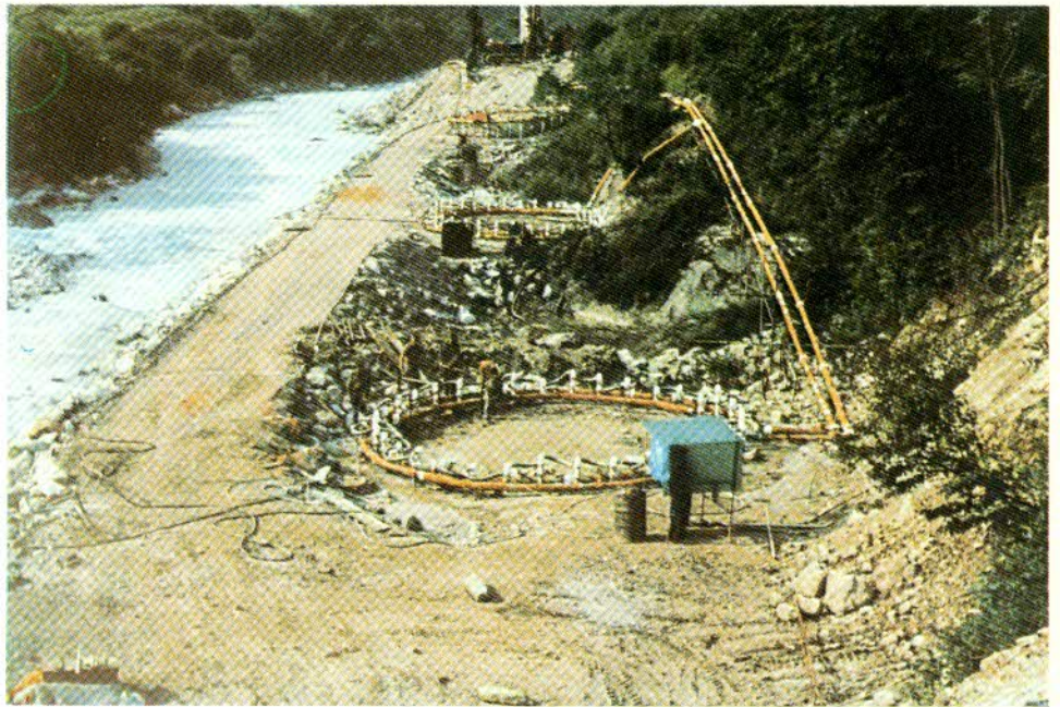
Fig. 7 - Serie di pozzi in fregio al Fella in fase di congelamento. Si notano i grossi tubi di andata e ritorno della salamoia e gli anelli di distribuzione, tutti coibentati con schiume poliuretaniche □ Wells beside the Fella river during the freezing operations. The pipes for the circulation of the "brine" can be seen; all the pipes were insulated with polyurethane foams
