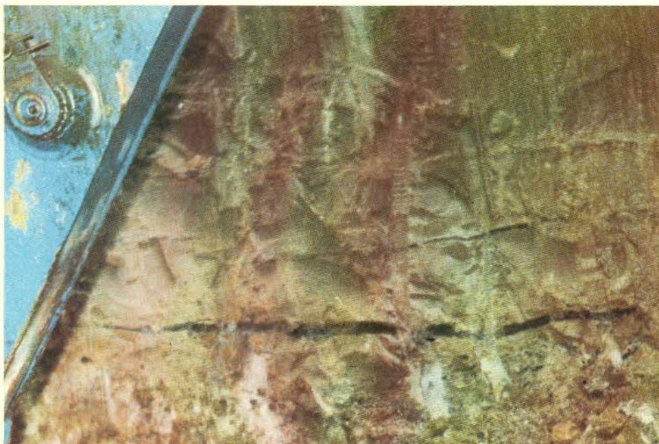
Fig. 8 - Pozzo n. 4 in fase di scavo attraverso un banco di sabbie limose. Sono chiaramente visibili le rotture del terreno provocate nel corso della prova d'iniezione con miscele cementizie. Il cemento non è in grado di «trattare» questo tipo di terreno □ Layer of sandy silt in the well no. 4. Horizontal soil breakages filled with cement can be seen: the cement grouting is not suitable
