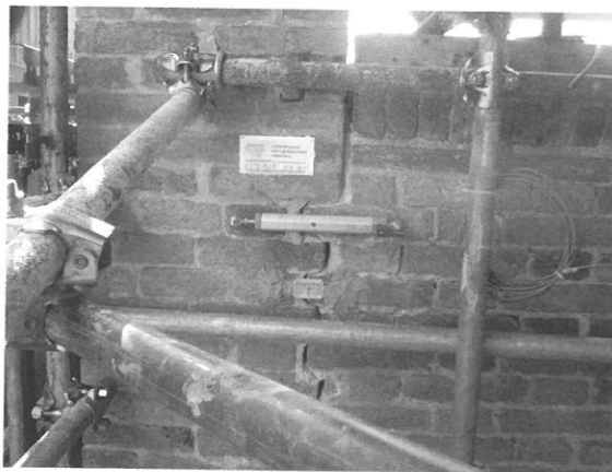
Foto 4. Misuratore di giunto a cavallo di una fessura
